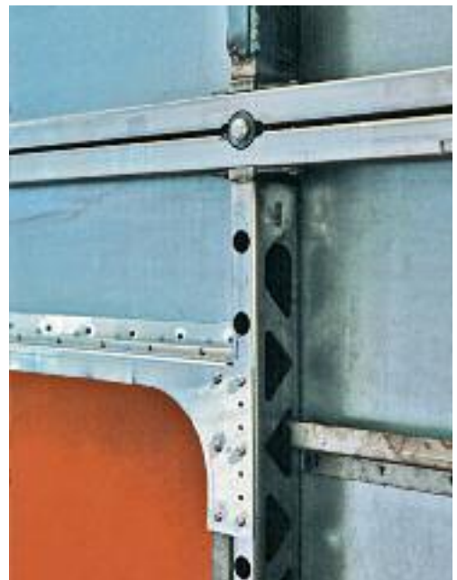
Figura 24: En los laterales de un tren de cercanías, la estructura y los paneles exteriores son de distintos tipos de acero inoxidable. Como todos ellos tienen potenciales idénticos, no se puede producir corrosión galvánica.
