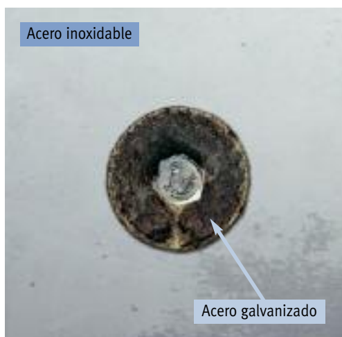
Figura 29: Prevención de la corrosión de contacto en acero galvanizado mediante el recubrimiento de un área pequeña en el elemento de acero inoxidable. Resultados de una prueba de spray con elevado contenido en cloruros durante 48 horas: sin un recubrimiento, la corrosión galvánica induce a la oxidación (izquierda), mientras que el recubrimiento del acero inoxidable en la zona de contacto evita la corrosión galvánica (derecha).
